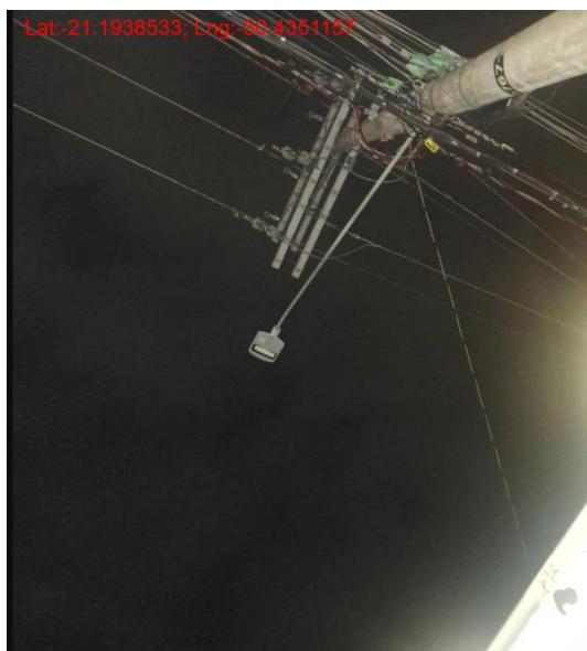
Figura 01 – Poste 15806 – Apagado (Endereço: Rua Dona Ida, 1210)
