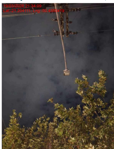
Figura 03 - Poste 10537 – Apagado (Endereço: Rua Almirante Barroso, 100)
