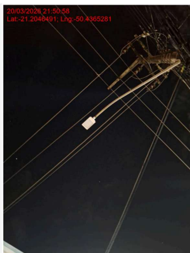
Figura 01 – Poste 09445 – Apagado (Endereço: Rua General Glicério, 335)
