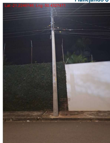
Luminária com ausência de Plaqueta – Poste 06180 – Rua Quintino Bocaiuva, 58 – Nova York
