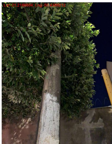
Luminária com ausência de Plaqueta – Poste ARA19716 – Rua Bernardino de Campos, 1234 – Vila Santa Maria
