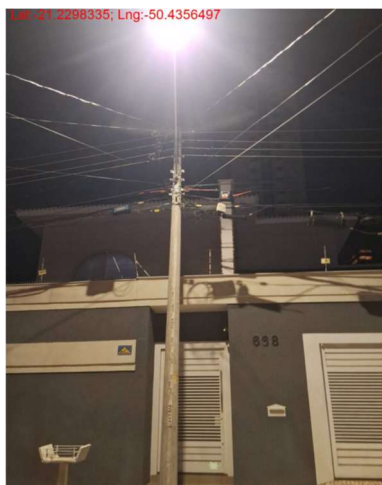
Luminária com ausência de Plaqueta – Poste 06196 – Rua Quintino Bocaiuva, SN – Nova York
