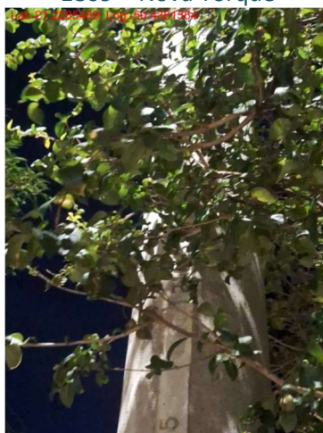
Luminária com ausência de Plaqueta – Poste 09752 – Rua Professor Jorge Correa, SN – Nova York
