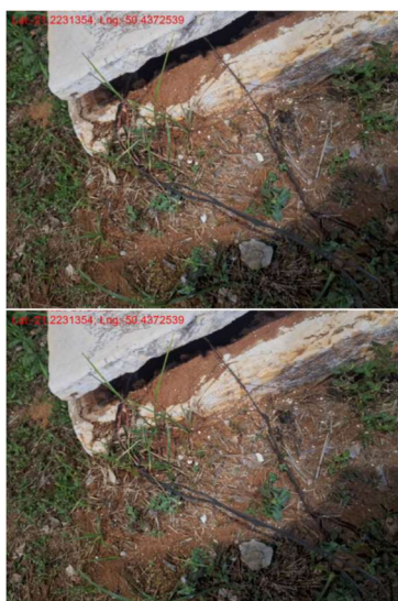
Luminária com Instalação Elétrica não conforme – Poste 11193 – Avenida Brasília, 1809 – Nova York
