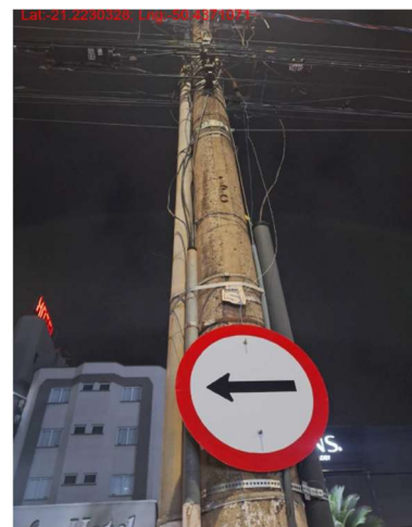
Luminária com ausência de Plaqueta – Poste 11126 – Avenida Brasília, SN – Nova York
