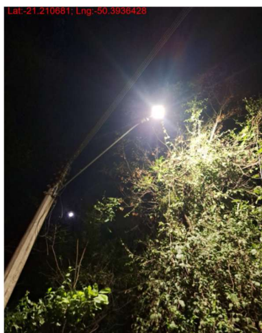
Luminária Virada – Poste 07197 – Rua Francisco Bruno, 1162 – Água Branca
